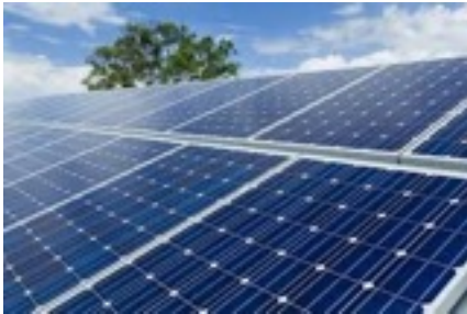
40kW Solar Array
